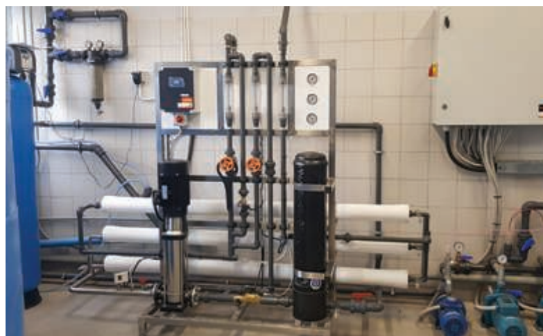
Fot. 11. Filtracja wody do spłukiwania odbywa się w procesie tzw. odwróconej osmozy.
