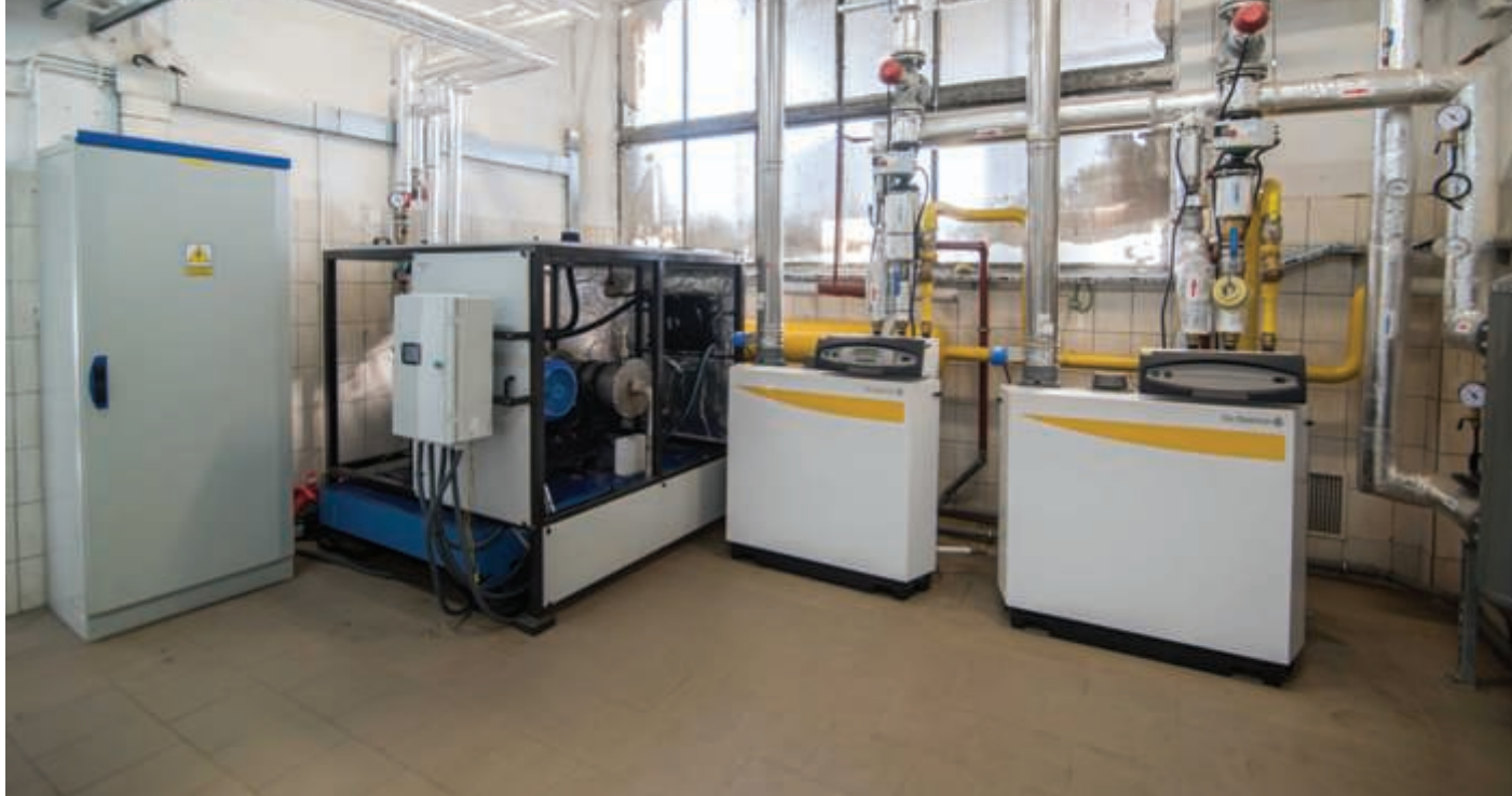
Fot. 2. Termomodernizacja przyniosła wymierne oszczędności finansowe. Na zdjęciu nowoczesna, bezobsługowa kotłownia.
